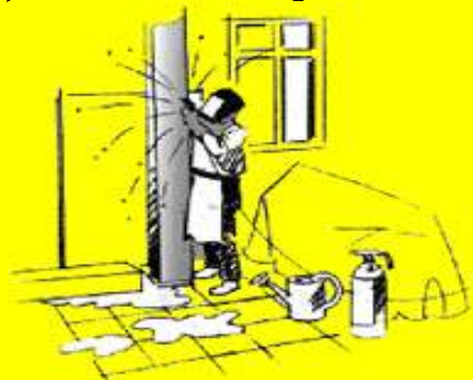
Fig.10 Es importante proteger las áreas que pueden estar expuestas a riesgo de fuego cuando se está soldando.
